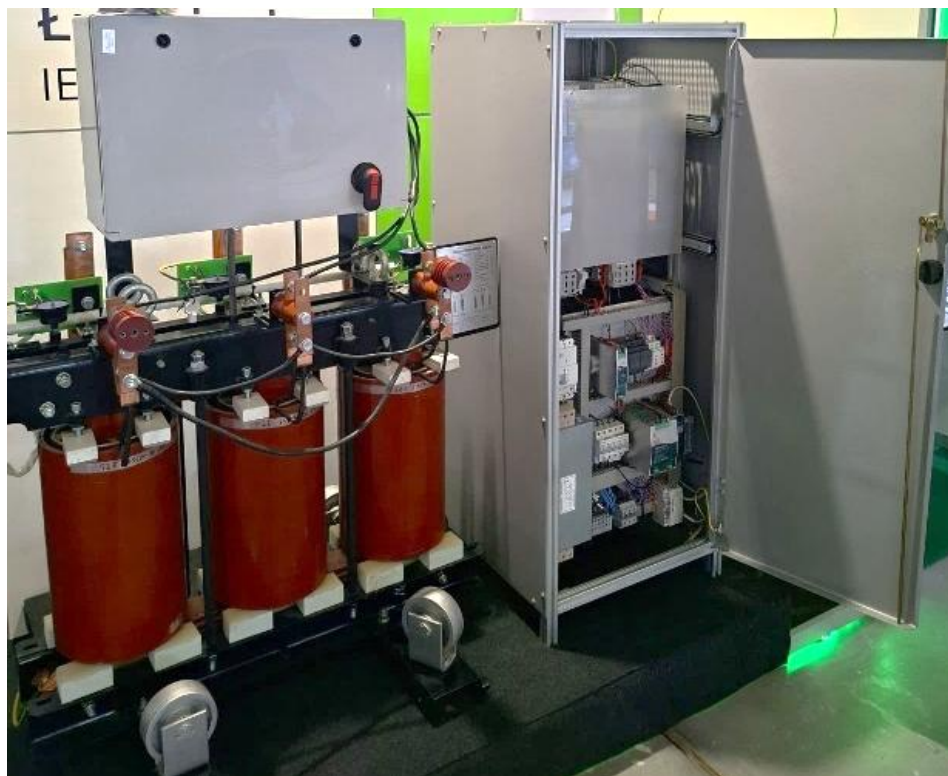
Rysunek 2. Energoelektroniczny regulator napięcia, przeznaczony do pracy w linii zasilającej nn o mocy do 630 kVA
